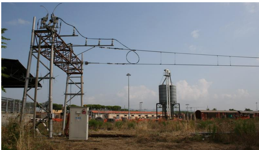
Figure 47 : Photographie de la ligne aérienne alimentée par la sous-station.
